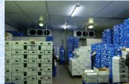
Chill Room Divisi Pasteurisasi
